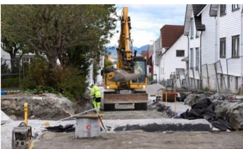
Lysø er stolte av å levere landets rimeligste fjernvarme. Fjernvarmenettet strekker seg i dag fra Sandnes via Forus og helt inn til Urban Sjøfront i Stavanger.
